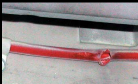
Firetrace tubing “burst”
